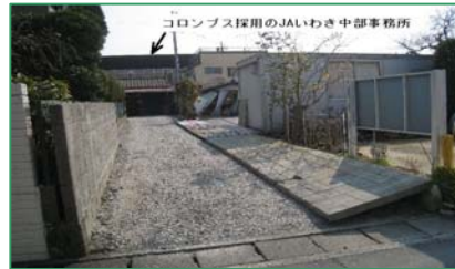
・近隣のブロック塀は倒壊
