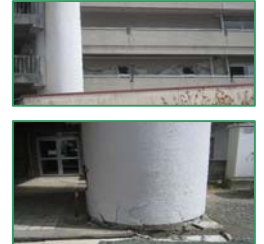
・柱脚の座屈破壊
