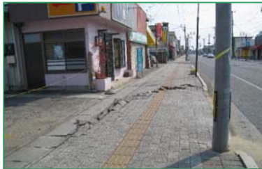
・歩道のインターロッキングへ亀裂
