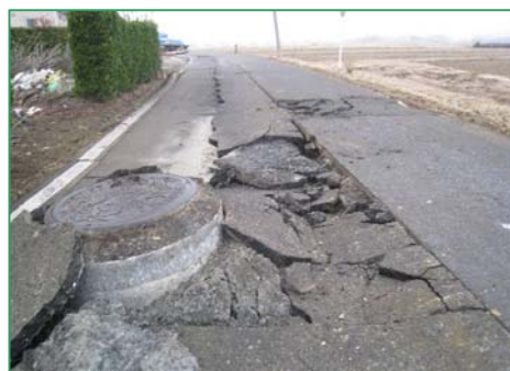
④【道路陥没】
