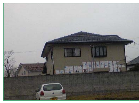
③【外壁が崩落した家屋】
