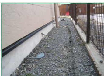
・建物周囲地盤へ亀裂
